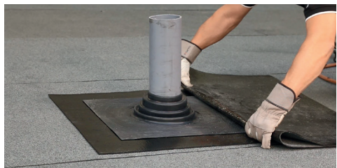
4. Påbörja intäckningen nedifrån med en kappan av tätskiktet. Arbeta alltid nedifrån takfallets riktning och upp.
