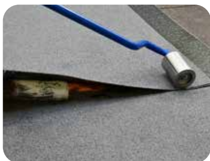
6. Rännaldalen är ett naturligt riskområde på taket. Var extra noga vid skarvar i rännaldalar.
