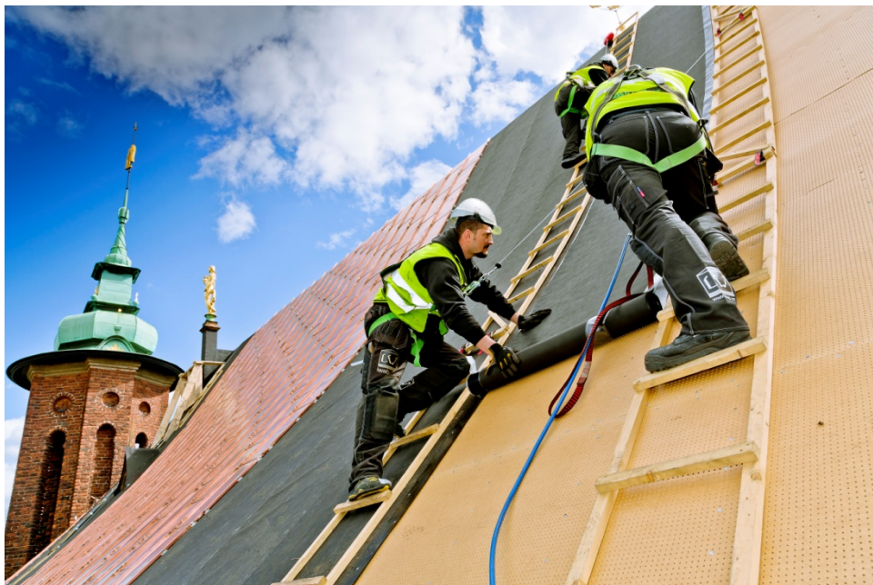
Takläggarna rullar ut Mataki Haloten Steel som används som underlagstäckning för det nya koppartaket på Stockholms stadshus.
